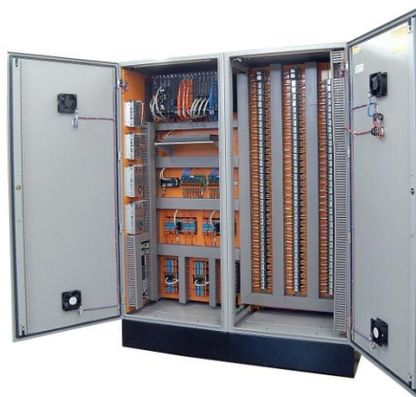
Figura 4 - Pannel de um Controlador Lógico Programável (CLP) da Altus, série AL-2000
